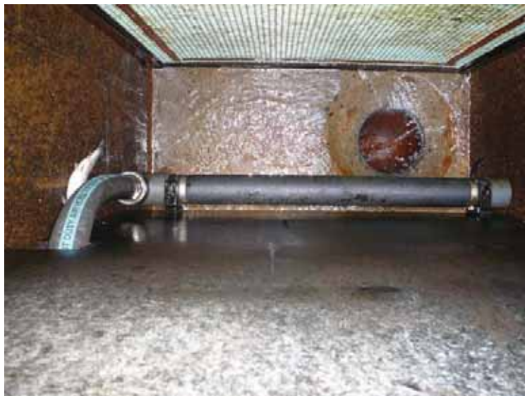
Figur 29 Eksisterende kummediffusor på Abildvad dambrug
