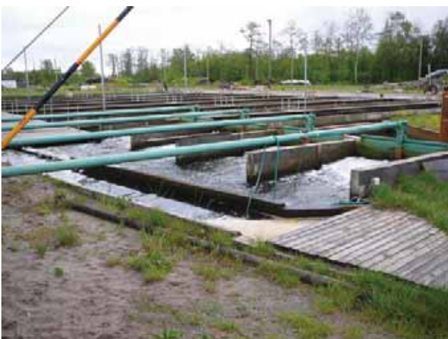
Figur 35 Mammutpumper / airlifts på Kølkær Dambrug
