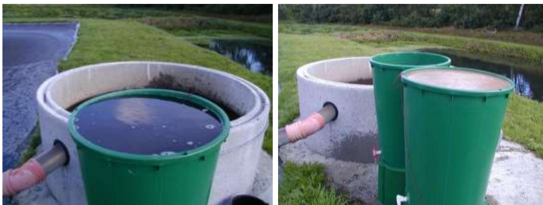
Figur 5-2 Forafvanding af slam udtaget fra slampumpebrønd.
